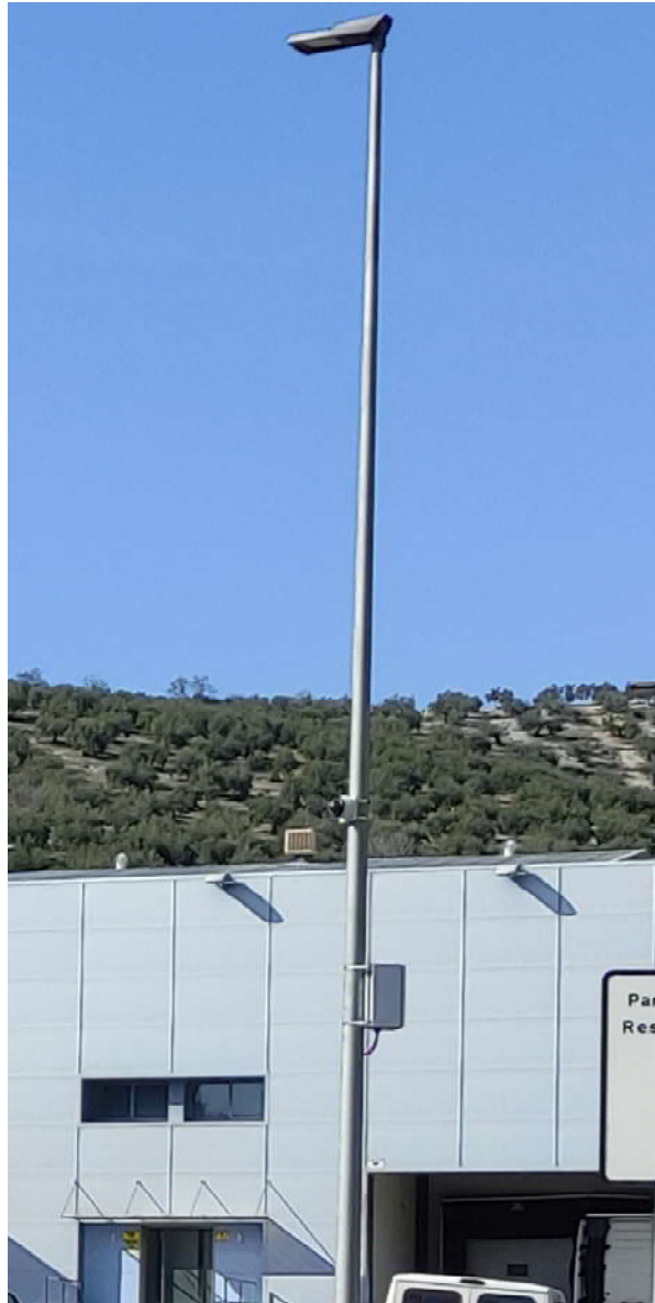
Cámara de videovigilancia sobre báculo de luminaria existente
