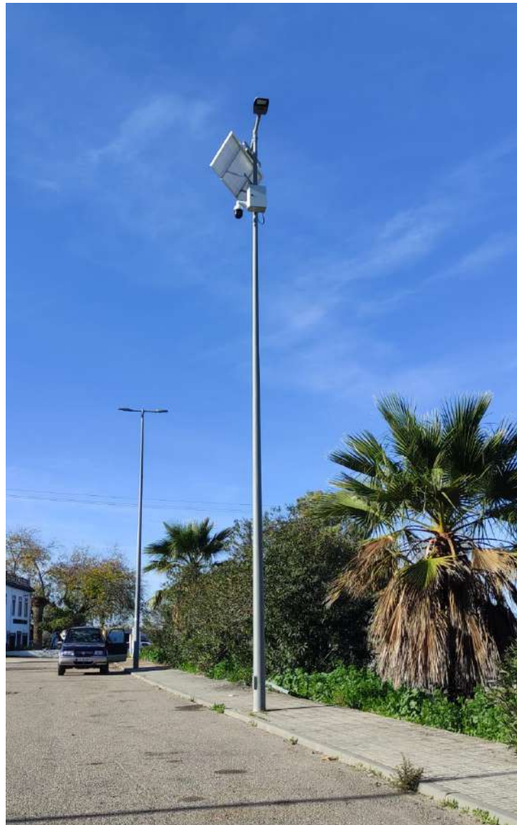
Instalación de cámaras de videovigilancia
