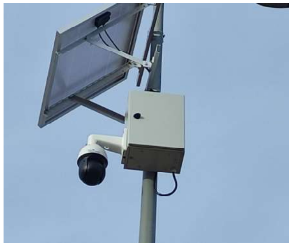
Cámara de videovigilancia sobre báculo de luminaria existente.
