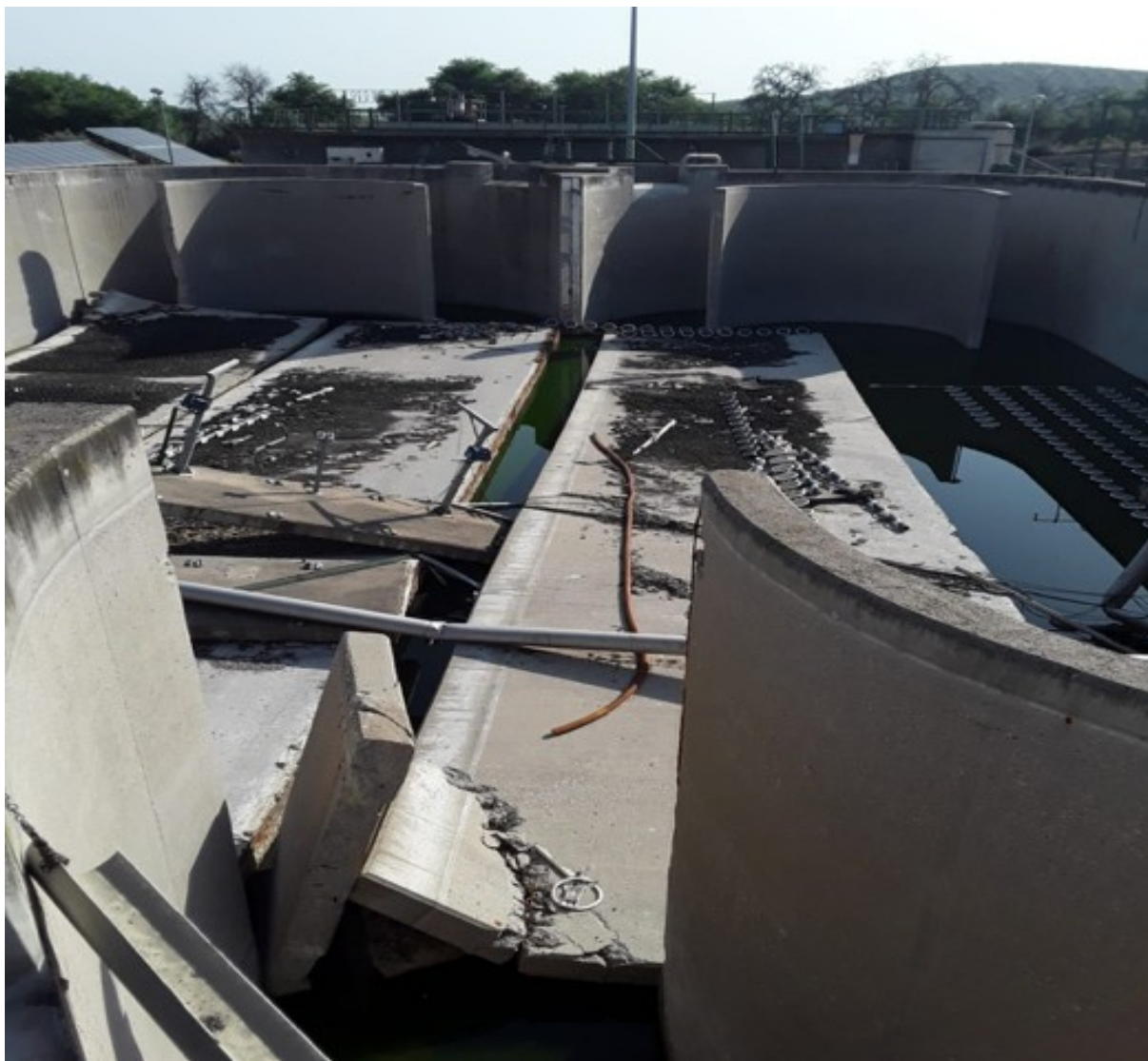
EDAR BUJALANCE - CAÑETE DE LAS TORRES
